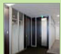
▼07...サーバールーム
