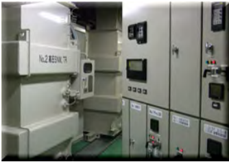
受電設備(B2Fに設置)
