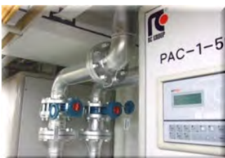
空調設備(各フロアに設置)
