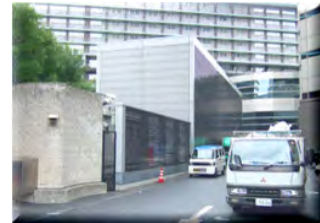
自家発電機(建物外に設置)
